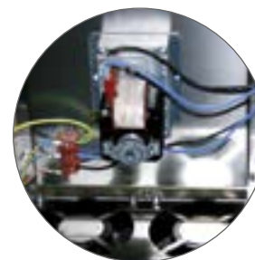
Ventilation des moteurs / Motors ventilation
